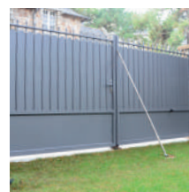
Barre de contreventement
